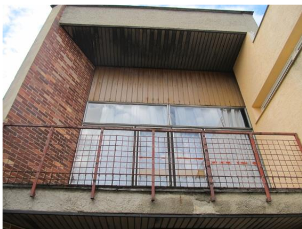
Prosklení nad vchodem, nevyhovující zábradlí a hydroizolace balkonu
