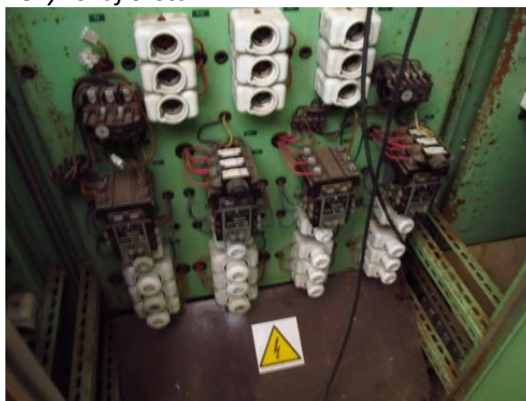
Částečně funkční rozvaděč v rozvodně
