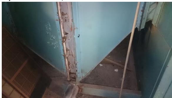
Stávající vzduchotechnická jednotka – nevyhovující stav
