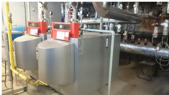
Plynová kotelna, instalace v r. 2015
