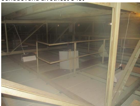
Půdní meziprostor – velmi nepříznivé podmínky, zejména vlhkost – koroze stropní a střešní konstrukce
