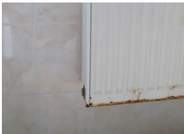
Koroze radiátorových těles v hale bazénu
