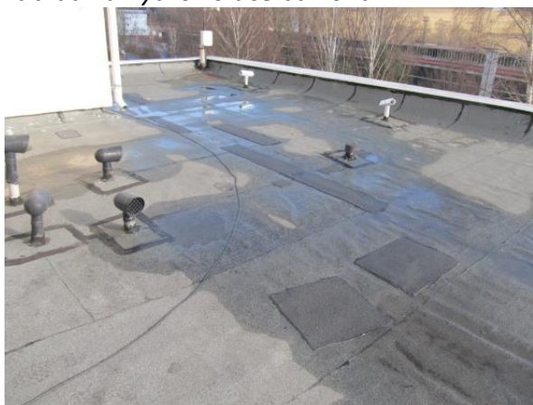
Opravovaná střecha nad šatnami – odhadovaná životnost 5 let
